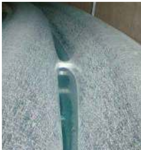
Das Einfrieren des Eisspeichers.
